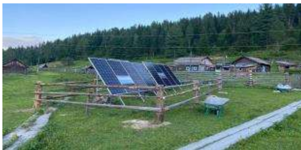
Рисунок 3 – Солнечные батареи в частных подворьях поселков Кузбасса
